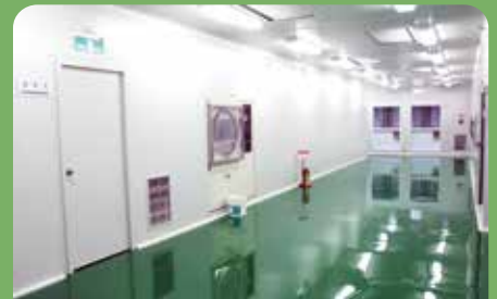
醫療級生產設備10,000級潔淨室
